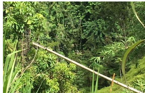
Tubería de distribución de agua potable sobre la superficie en la zona rural de Puerto Rico rota a causa de un huracán. (Fotografía de la OIG de la EPA)
