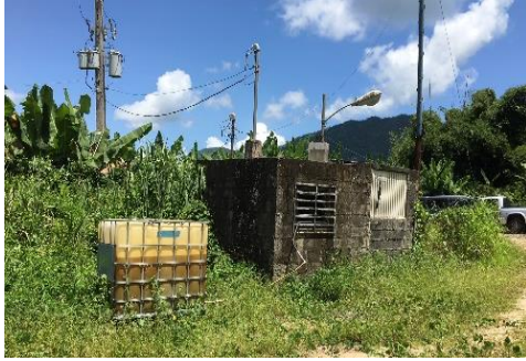
Sistema rural secundario de agua potable en Puerto Rico con las sustancias químicas de tratamiento indebidamente almacenadas afuera y expuestas. (Fotografía de la OIG de la EPA)
